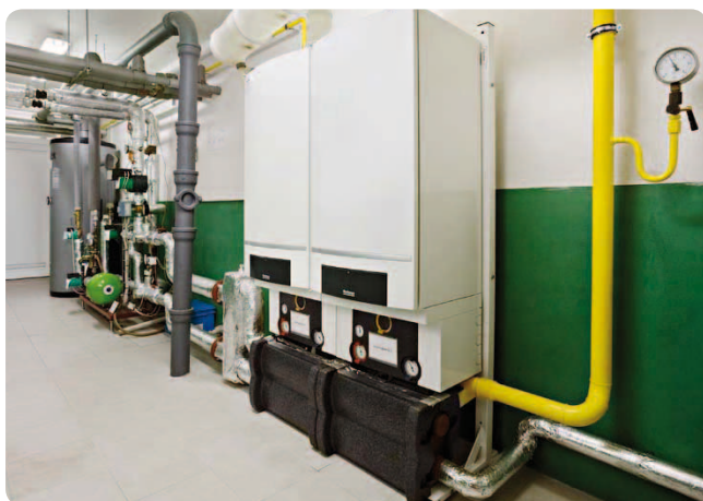
Obr. 2.: Modernizovaná kotelna s kotli Buderus
